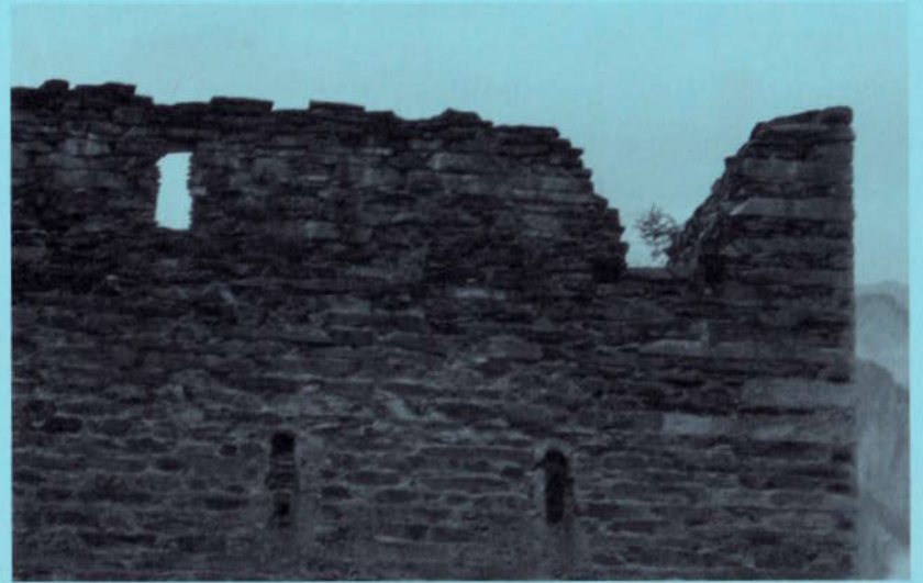
Auch ein Tännchen hat auf der Mauerkrone Wurzeln gefasst
