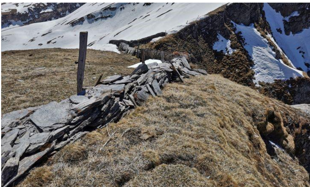
Abbildung 9: Zerstörungen an der Grenzmauer beim Calandatörli
